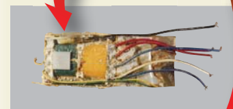
劣化が進みつつある安定器
