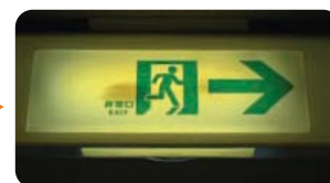
劣化した表示板の例
