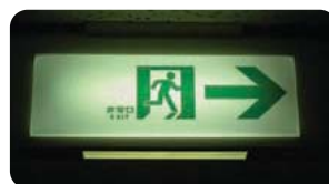
正常な表示板
