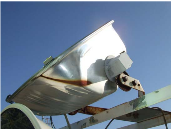
部品が錆びた状態で使用
